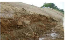
盛土法尻部の表層崩壊
