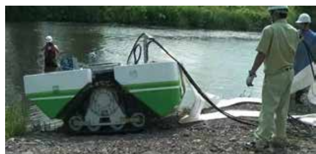
訓練での運転状況
