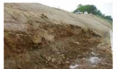
盛土法尻部の表層崩壊
