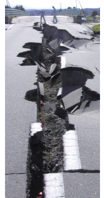
泥炭地盤上の 道路盛土の地震被害
