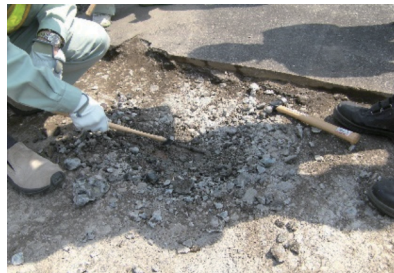
土砂化した橋梁床版
