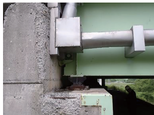
橋台に生じたスケーリング
