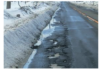
融解期の舗装の損傷例
