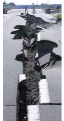
泥炭地盤上の道路盛土の地震被害
