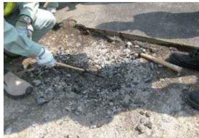
土砂化した橋梁床版
