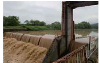
濁水が流下する頭首工付近の状況
