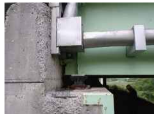
橋上に生じたスケーリング
