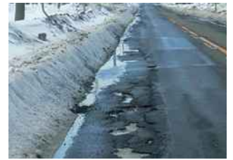
融解期の舗装の損傷例
