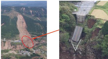
平成28年熊本地震の影響により復旧に長期間を要す被災が生じた橋
