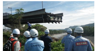
橋梁の被災状況調査（令和元年台風19号）
