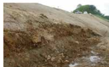
盛土法尻部の表層崩壊
