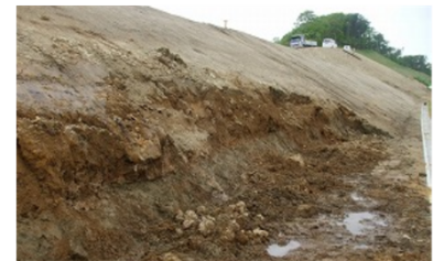
盛土法尻部の表層崩壊
