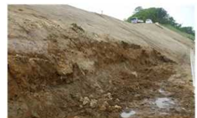
盛土法尻部の表層崩壊
