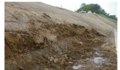
盛土法尻部の表層崩壊
