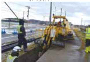
電線共同溝工事でのトレンチャーによる掘削施工状況
