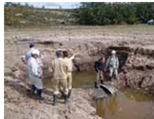
地震災害により被災した農業用管路
