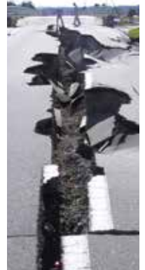
泥炭地盤上の道路盛土の地震被害
