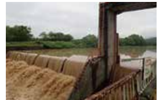
濁水が流下する頭首工付近の状況
