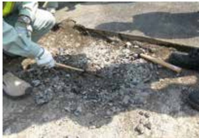
土砂化した橋梁床版
