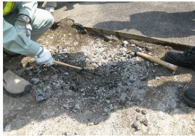
土砂化した橋梁床版
