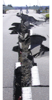
泥炭地盤上の道路盛土の地震被害
