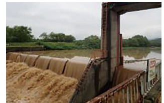
濁水が流下する頭首工付近の状況
