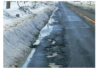
融解期の舗装の損傷例
