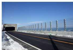
設置状況 (一般国道336号)
