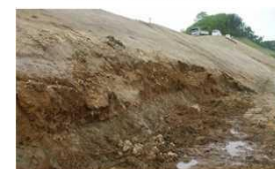
盛土法尻部の表層崩壊
