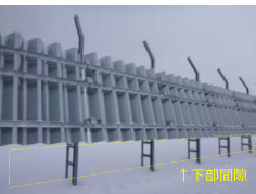
設置状況（石狩吹雪実験場）
