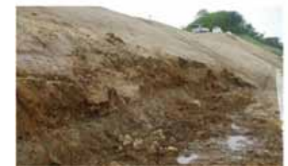
盛土法尻部の表層崩壊
