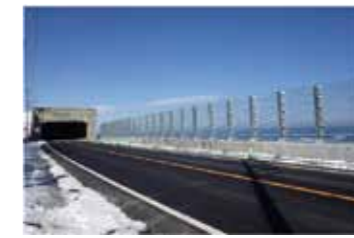
設置状況(一般国道336号)
