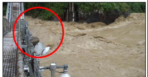
設置・観測例
