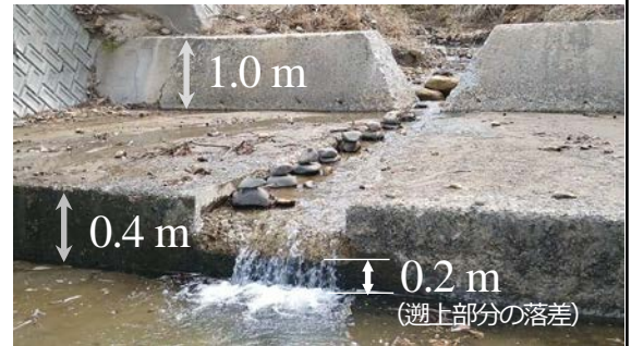
切欠き魚道の設置（竜の口溪谷） （水面落差の改善 1.4 m ⇒ 0.2 m）
