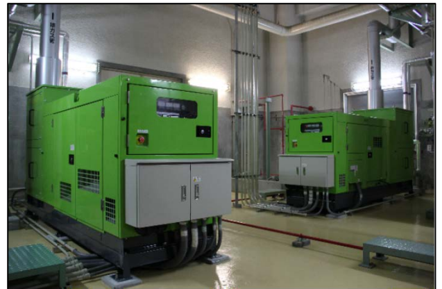
消化ガスエンジン導入例
