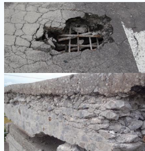
橋梁RC床版の劣化損傷事例
