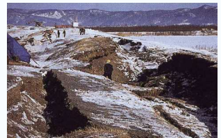
泥炭地盤上の盛土の地震被害
