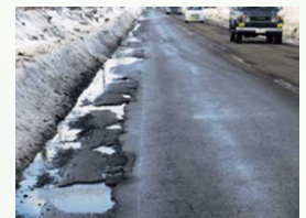
凍結融解等による舗装損傷
