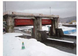
凍雪・摩耗を受ける頭首工堰柱
