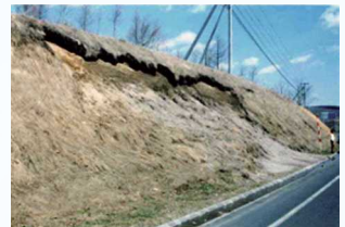
凍上・凍結融解による被害状況
