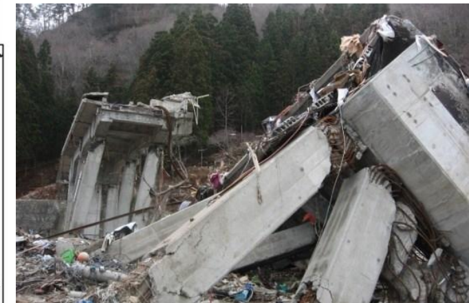
津波による橋梁流出
