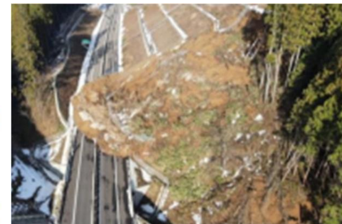
地震による法面崩落
