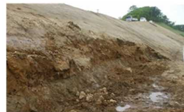
盛土法尻部の表層崩壊
