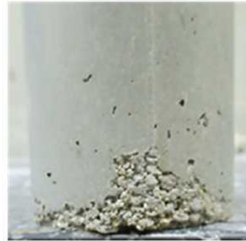
円柱型枠 直接吹付け 乾式での 豆板発生状況
