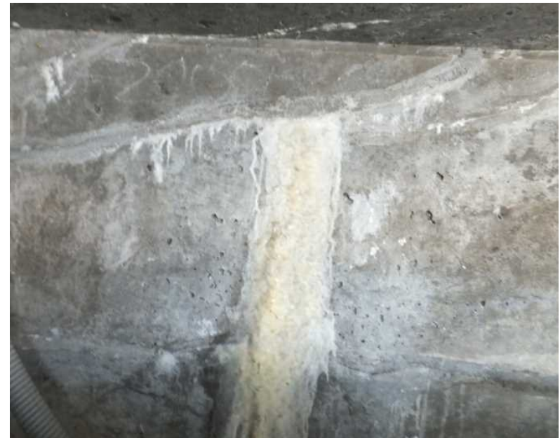
ひび割れUカット充填後の漏水と析出物の再発例（注入後1年）
