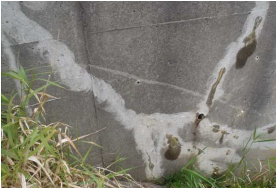
ひび割れ注入後の漏水と析出物の再発例（注入後10ヶ月）
