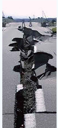
泥炭地盤上の 道路盛土の地震被害
