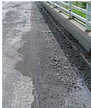
土砂化した橋梁床版
