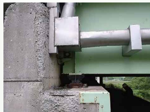
橋上に生じたスケーリング
