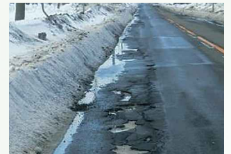
融解期の舗装の損傷例
