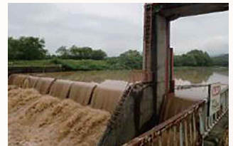
濁水が流下する頭首工付近の状況
