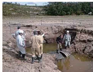
地震災害により被災した農業用管水路
