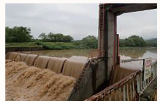
濁水が流下する頭首工付近の状況
