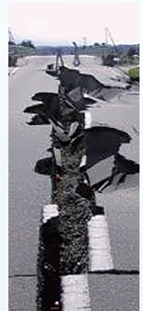
泥炭地盤上の 道路盛土の地震被害
