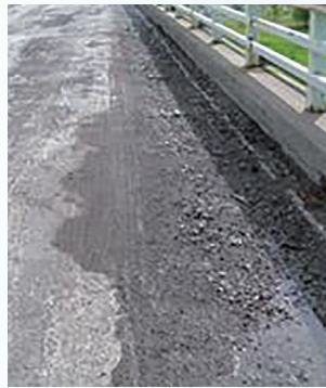
土砂化した橋梁床版
