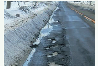
融解期の舗装の損傷例
