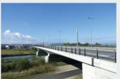
青緑みのグレー 5B5/1 照明柱; 旭川市北彩都地区クリスタル橋
