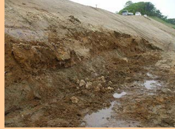
盛土法尻部の表層崩壊
