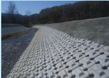
護岸ブロックの変状
