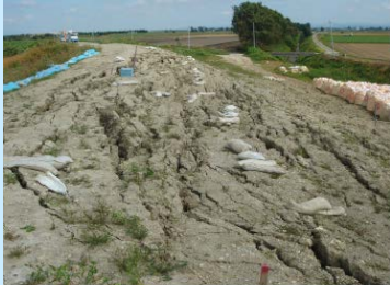
築堤盛土のすべり崩壊
