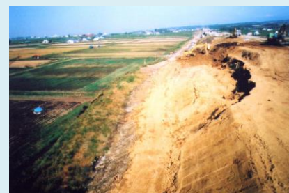
盛土による泥炭地盤の破壊
