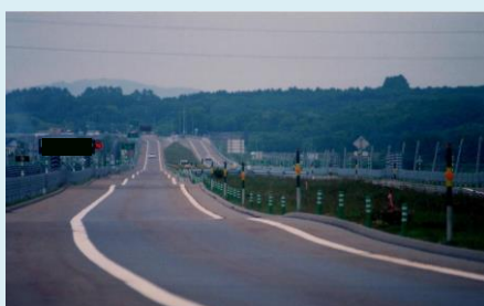
沈下による道路の凸凹
