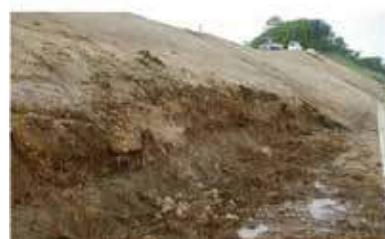
盛土法尻部の表層崩壊
