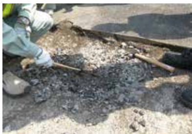
土砂化した橋梁床版
