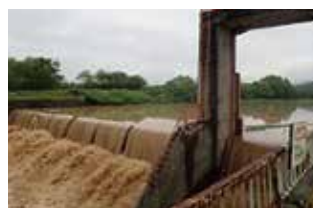
濁水が流下する頭首工付近の状況
