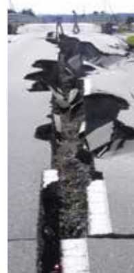
泥炭地盤上の道路盛土の地震被害
