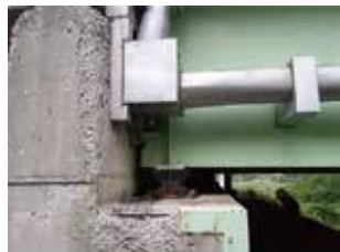
橋台に生じたスケーリング
