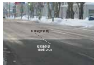
機能性SMAの冬期路面時の状況例
