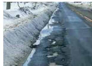
融解期の舗装の損傷例
