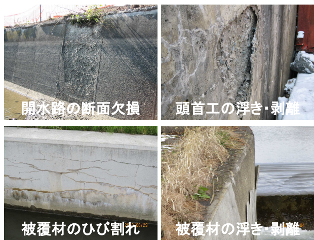
コンクリートの凍害と補修材の早期劣化
