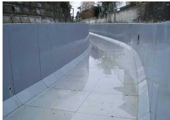
寒地農業用水路の補修におけるFRPM板ライニング工法
