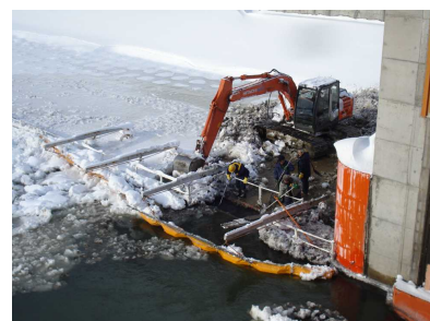
水道取水口に堆積した晶氷除去の様子(2013年1月:写真は名寄市提供)
