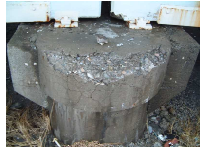
凍害を受けたコンクリート
