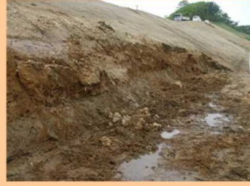
盛土法尻部の表層崩壊
