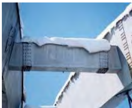
【橋梁の着雪状況】
