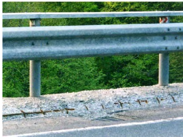
【スケーリング被害状況】
