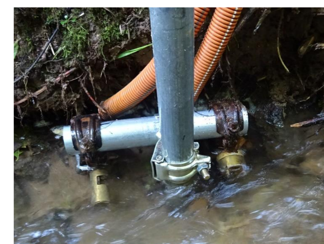
低濃度用と高濃度用の濁度計の設置状況
