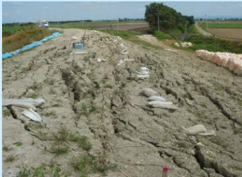
築堤盛土のすべり崩壊
