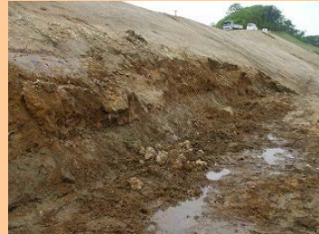
盛土法尻部の表層崩壊
