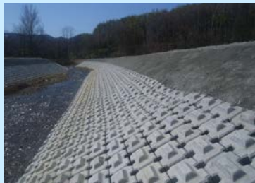
護岸ブロックの変状
