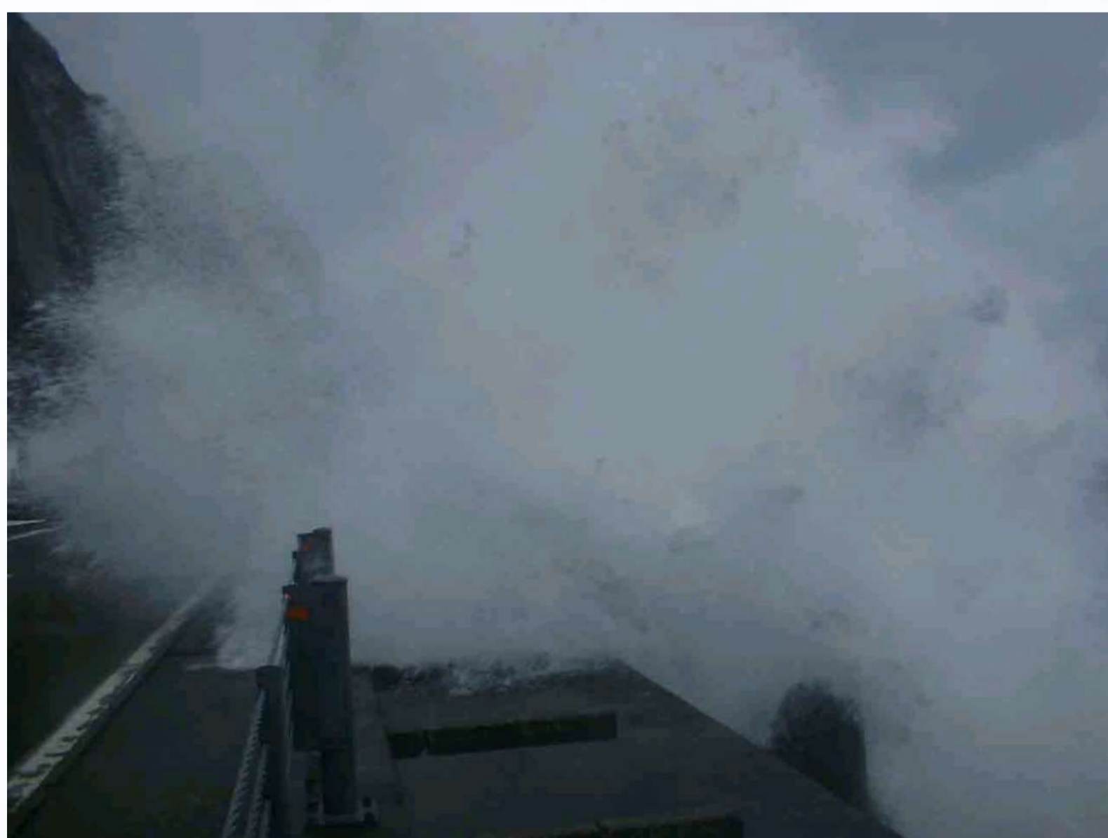
防波フェンス設置前の越波状況
