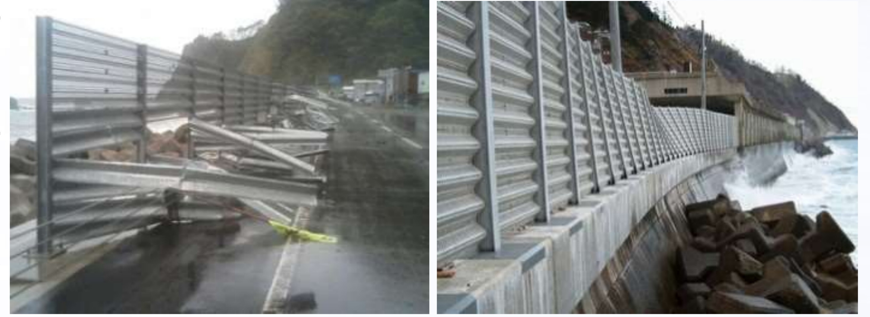
越波による防波フェンスの破損事例
