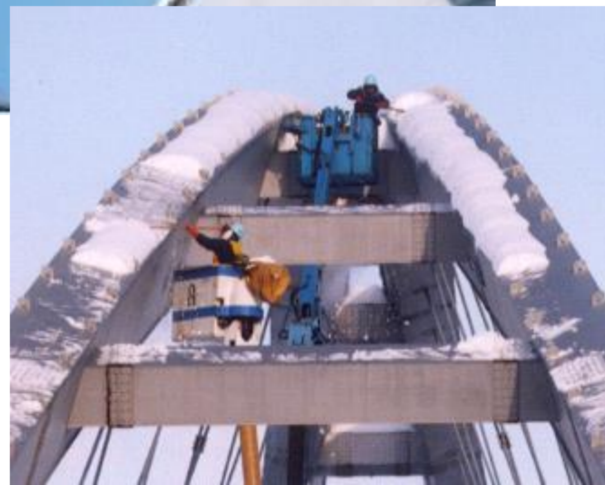
着氷雪状況と人力による雪下ろし作業
