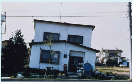
沈下による家屋の傾き
