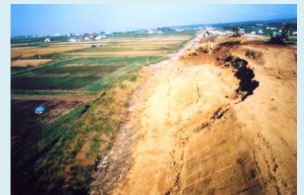
盛土による泥炭地盤の破壊
