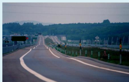
沈下による道路の凸凹
