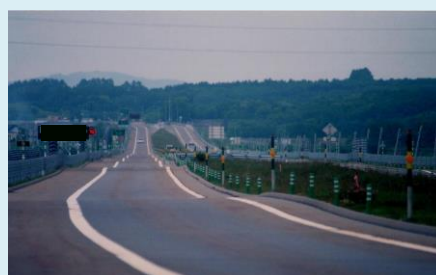
沈下による道路の凸凹
