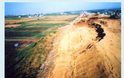
盛土による泥炭地盤の破壊
