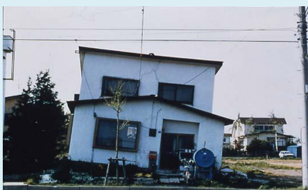
沈下による家屋の傾き
